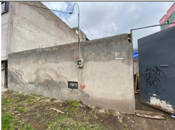
Imagen No. 1: Vista general de la Edificación-Cerramiento, portón de ingreso, predio No. 163901.
