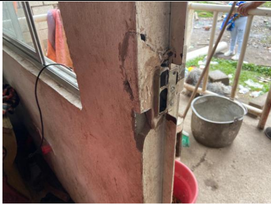
Imagen No. 9: Se constata humedad en la edificación. No se constata ningún proceso constructivo recién o en marcha.
